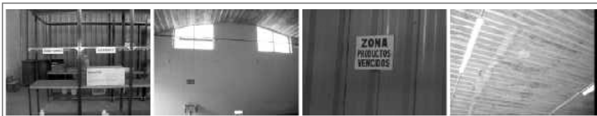
Figura 42. Instalaciones de almacenamiento de pesticidas
